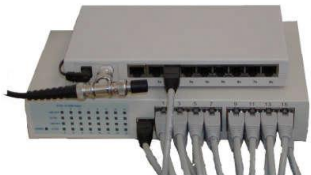
Hore HUB, pripojenie koaxiálnej siete so sieťou TP dole SWITCH, prepojenie počítačov v sieti TP
